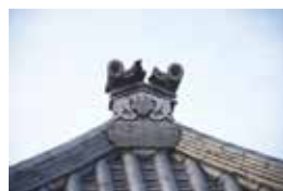
三重県津市一志町 浄福寺 8/24本堂の屋根に落雷がありました。
